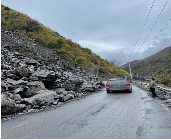
图2 浆砌挡土墙+被动网损毁情况
