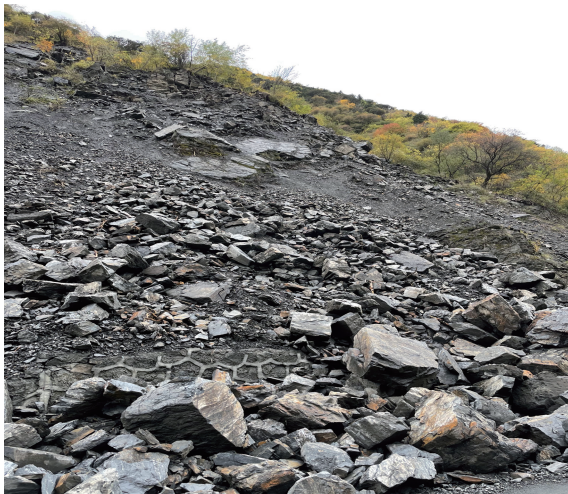
图3 浆砌挡土墙被掩埋堆积
