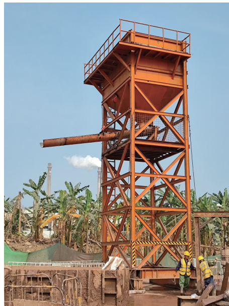
图 19 混凝土输料架
