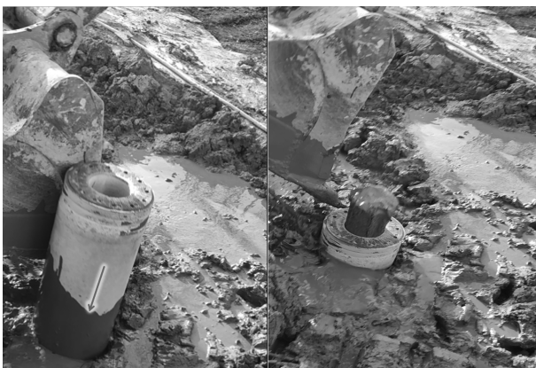
图17 铲斗松脱吊装带使管桩下落
