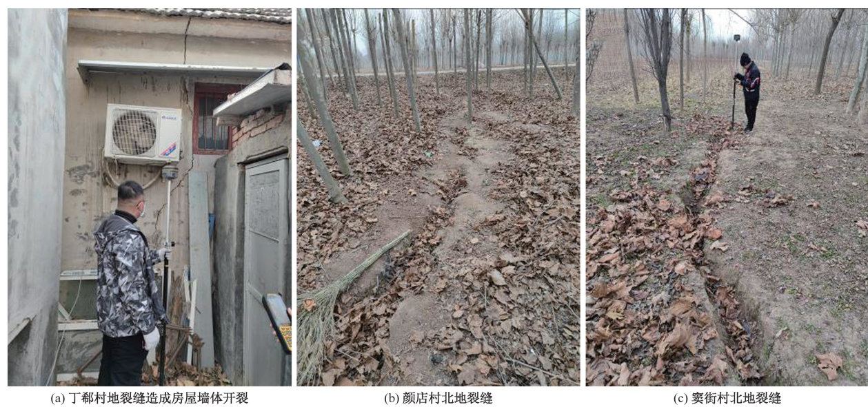
图 3 房屋开裂及地裂缝
