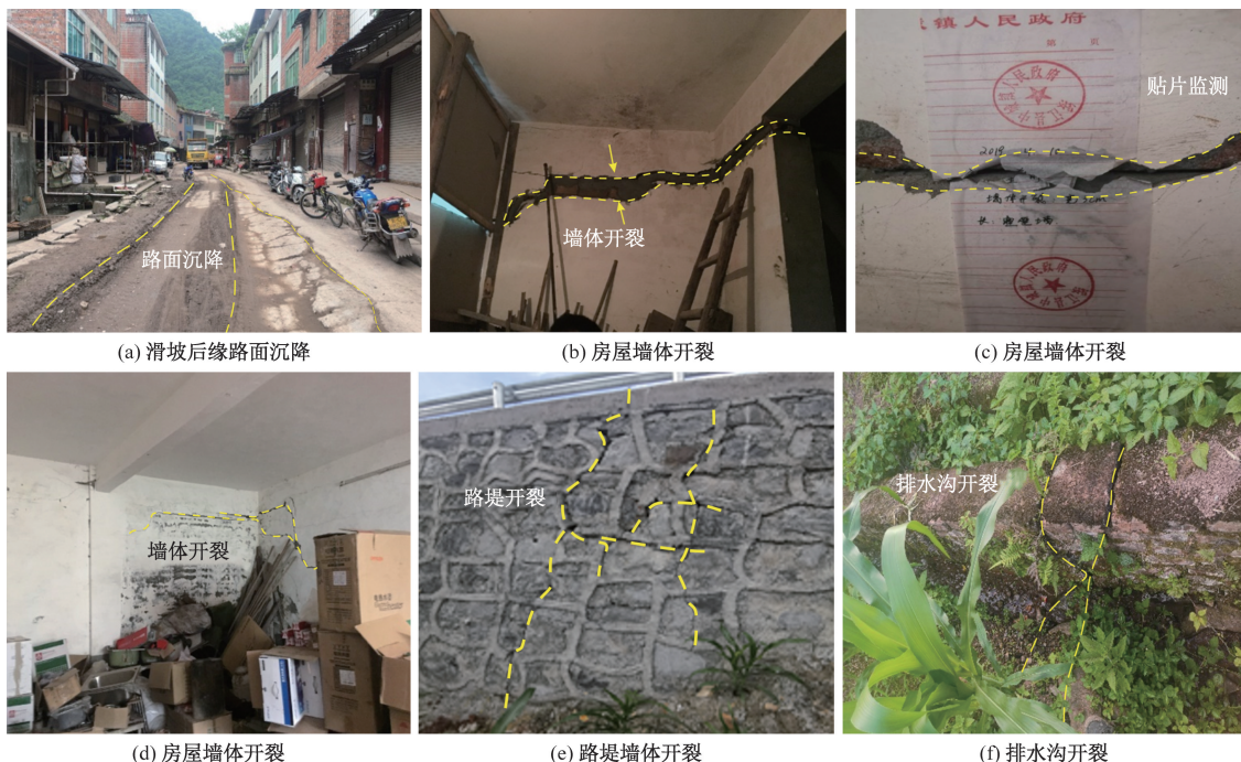
图 4 滑坡变形破坏情况
