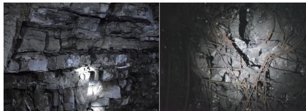
图7 强采动巷道高度裂隙化围岩体
