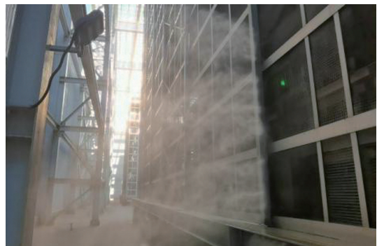
图5 燃机罩壳滤网机器人冲洗
