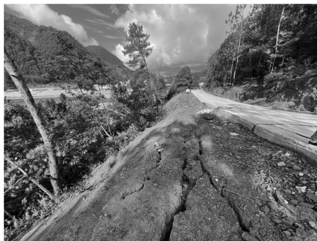
图2 滑坡前缘裂缝
