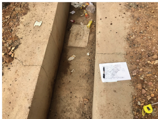
图5 排水沟拉张裂缝
