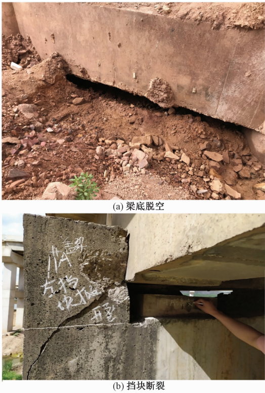
图 6 滑坡导致桥梁梁底脱空和挡块断裂
