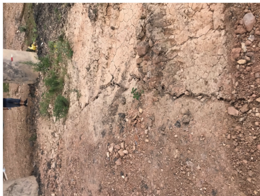
图4 余家海滑坡后缘拉张裂缝
