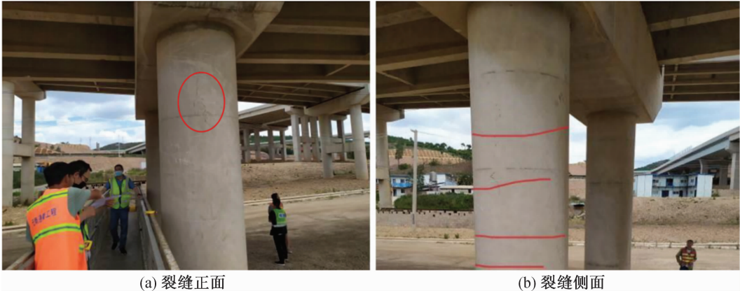
图 2 B 匝道桥墩裂缝
