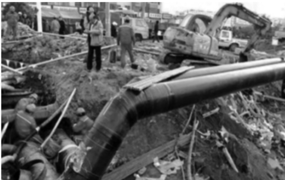
图 1 直埋燃气管泄漏事故现场
