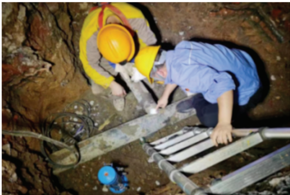
图 2 直埋燃气管泄漏事故现场处置
