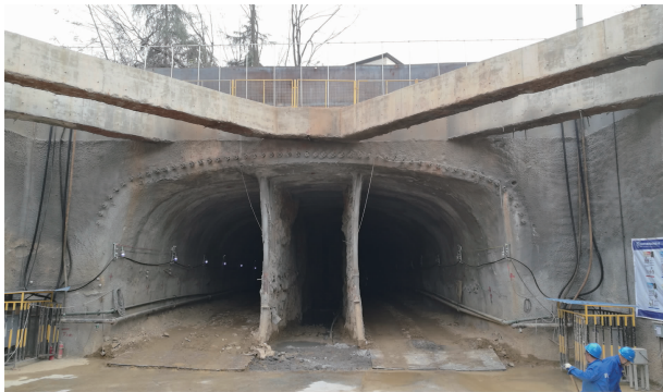
图 1 武汉某排水通道工程
