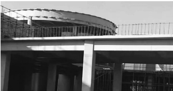
图 10 中白科技园连廊清水混凝土外观质量情况
