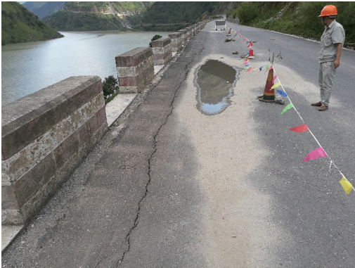
图 3 K79+390~K72+450 段路面开裂
