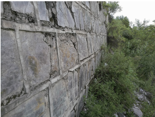
图 4 K79+390~K72+450 段挡墙变形、开裂
