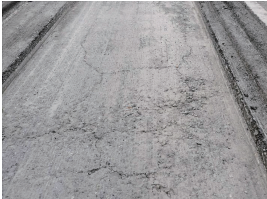
图 8 开挖后基层病害情况
